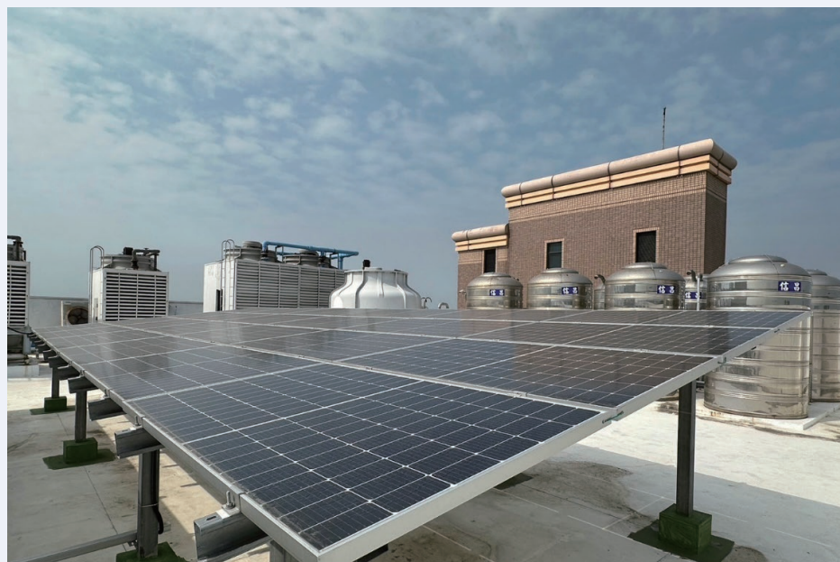
彰化分行屋頂太陽能發電系統
